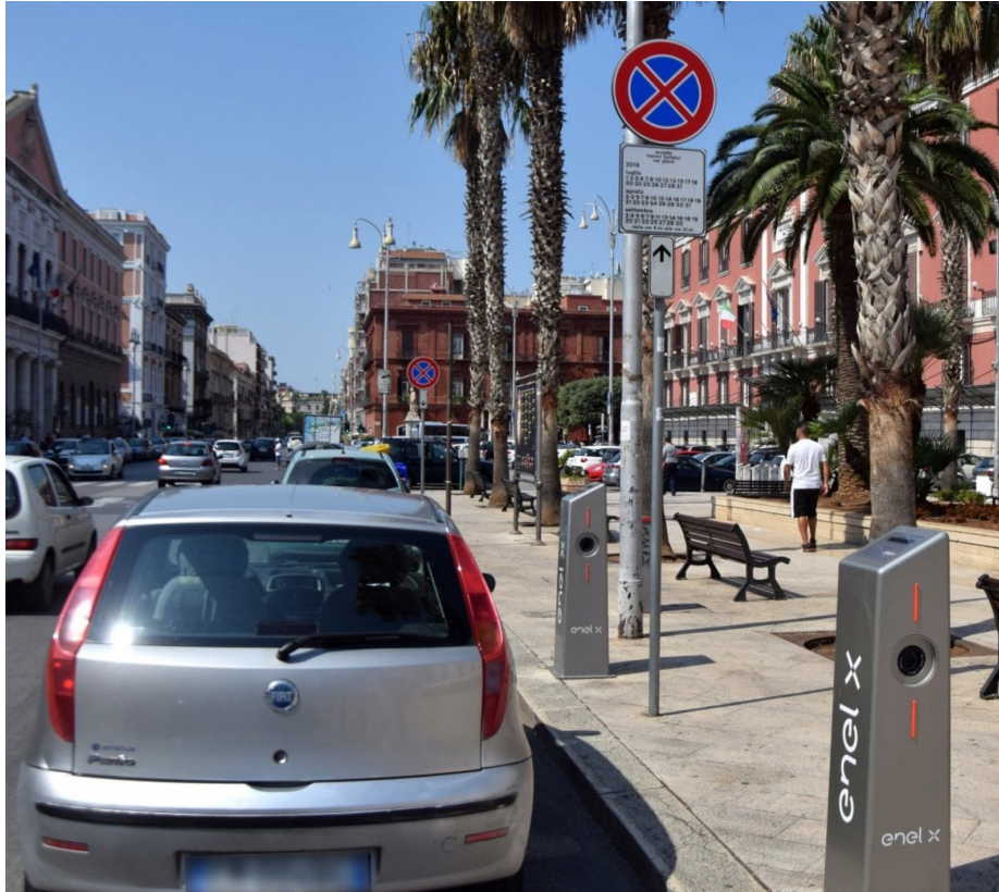
Infrastruttura di ricarica in una strada di Bari. Immagine pubblicata nella notizia del 24.09.2025. Provenienza
